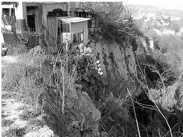
Figura 8. In primo piano il settore interessato da un crollo nel dicembre 2003, con regressione della scarpata di circa 2 metri.
